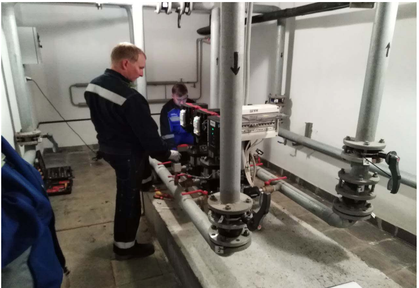
Настройка повысительной насосной станции.
