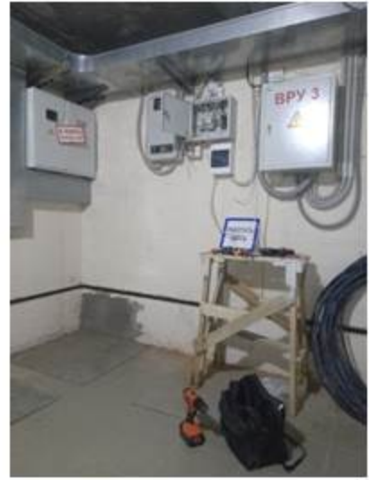
Регламентные работы в электрощитовой
