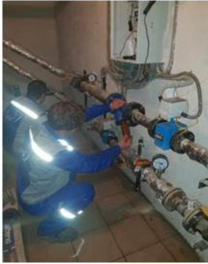
Чистка фильтров ГВС
