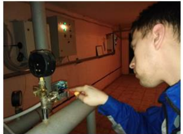
Обслуживание ИТП , ПВНС
