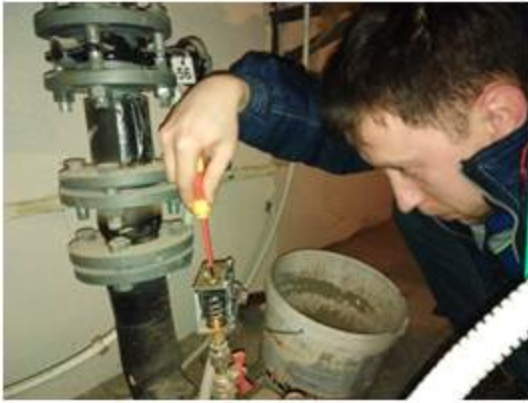
Обслуживание ИТП, ПВНС
