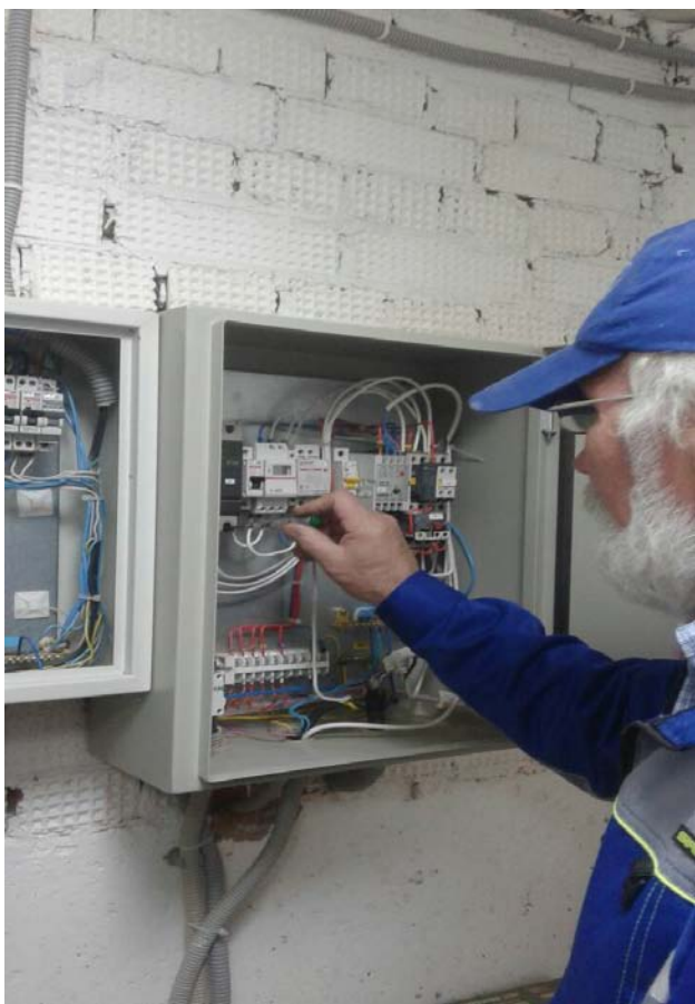
Регулировка тайм реле системы освещения.
