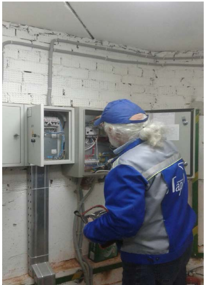
Чистка силовых щитов от пыли в электрощитовой
