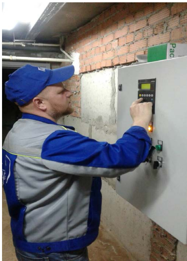
Настройка режимов работы повысительных насосов.
