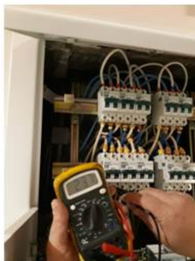
Замеры напряжения в этажном щите
